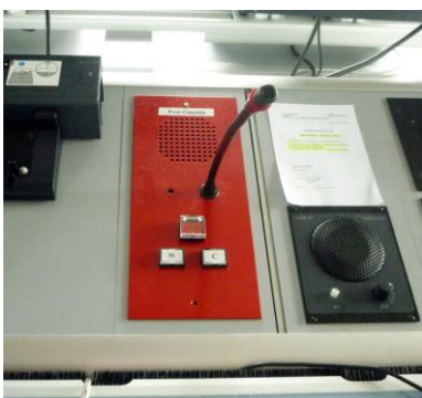
Notrufsprechstelle für die direkte Alarmierung der Flughafenfeuerwehr – Notruftaster mit Schutzdeckel
